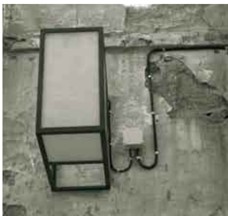
Farolas en Pozos Dulces, donde no se ha resuelto de manera satisfactoria el cableado.
